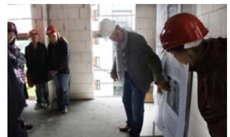
Der Architekt Henryk Stutz und Besucher auf der offenen Baustelle H3 in Schwein | Foto: Architektenkammer M-V
